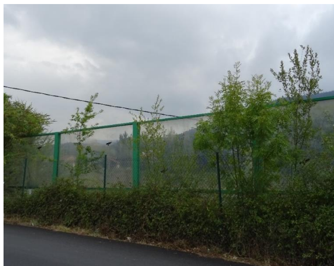
Pantalla acústica y cerramientos afectados
